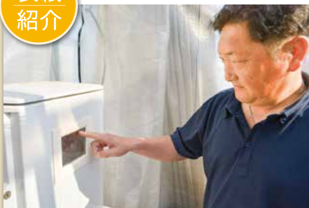
▲制御盤を操作
